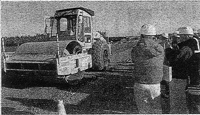
GPSによる転圧管理システムを導入した工事現場を見学する参加者
