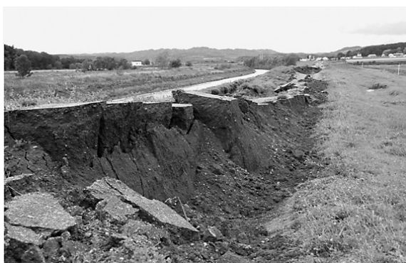
▶十勝沖地震による被害状況
